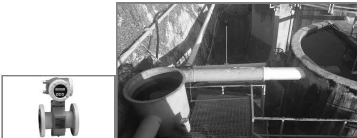
Figura 4 - Misuratore di portata elettromagnetico e suo punto d'installazione.
